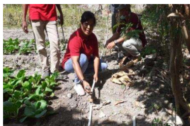
Instalasi irigasi Sprinkel
