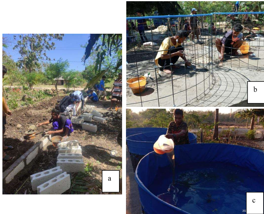
Gambar 3. Kegiatan inventarisasi sarana dan prasarana kegiatan. a) Pembuatan alas kolam. b) Pemasangan kerangka kolam central drain. c) Penebaran media flok pada media air pemeliharaan
